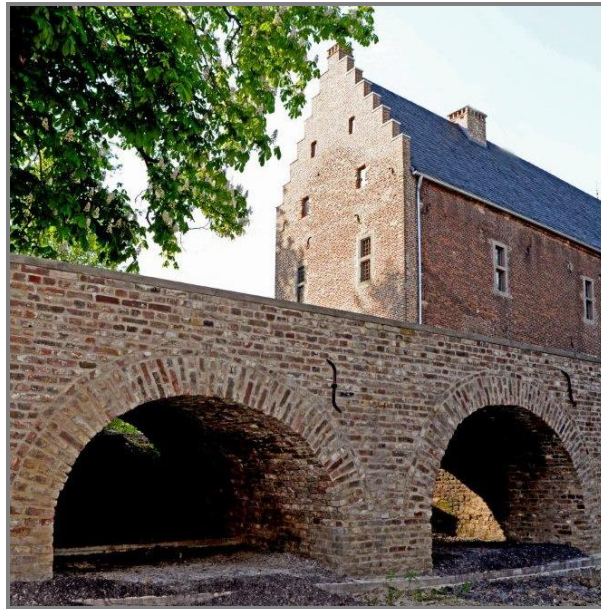
Burg Engelsdorf: Vorhof-Brücke (Restaurierung 2016 abgeschlossen) im Hintergrund der 2007 bis 2015 im Bestand gesicherte Pallas mit Schaugiebel
